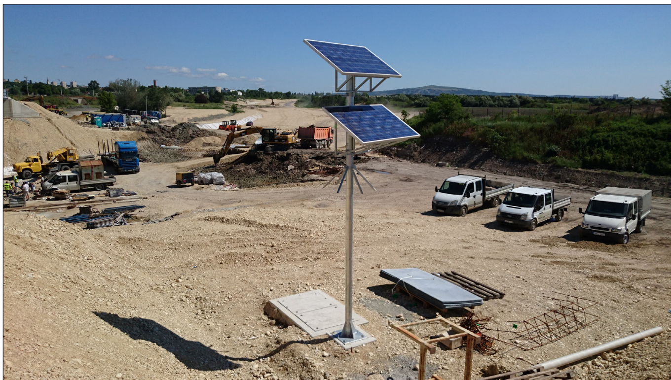
15. ábra: Az üzemeltetést kiszolgáló napelemek
